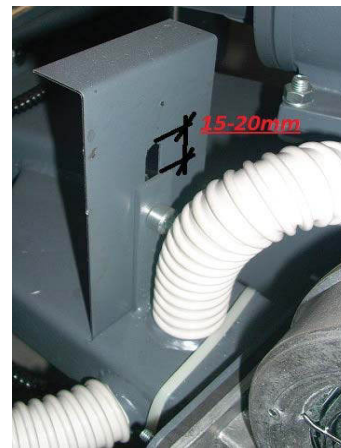
Положение направляющей воздушной заслонки системы безопасности
